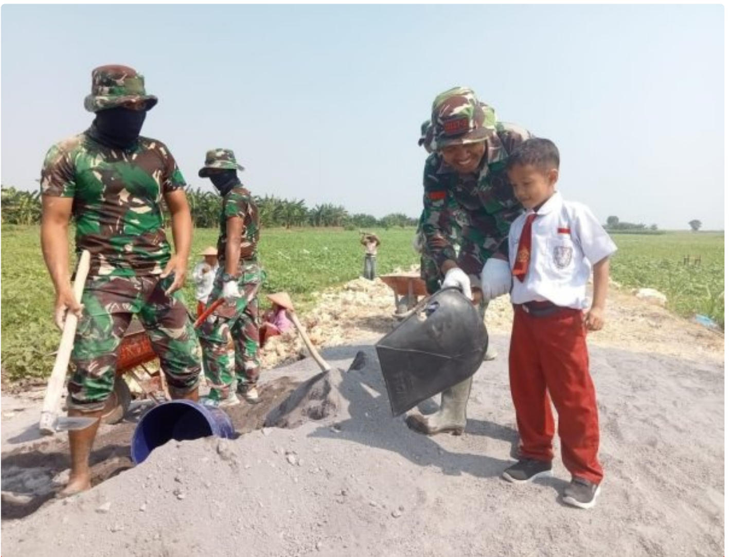
Rizki Akbar (8) Anak Kelas 2 SDN Cangkring Antusias Melihat Bapak Tentara Bekerja Membangun Saluran Tersier Di Desanya
